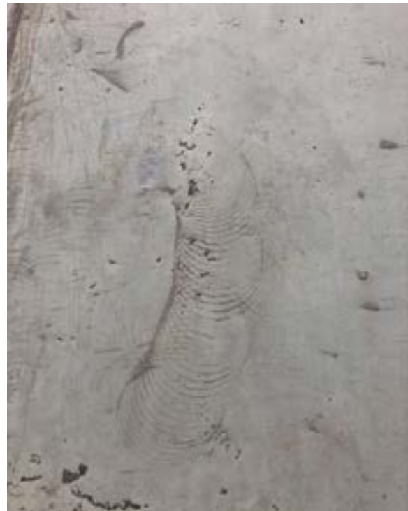
Rastro que deja el vibrador en el hormigón.
