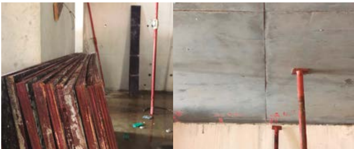
Incorrecto apuntalamiento entre tableros.
