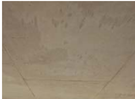
Efecto rippling en el hormigón.
